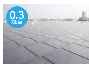
■ 西島太陽光発電所
